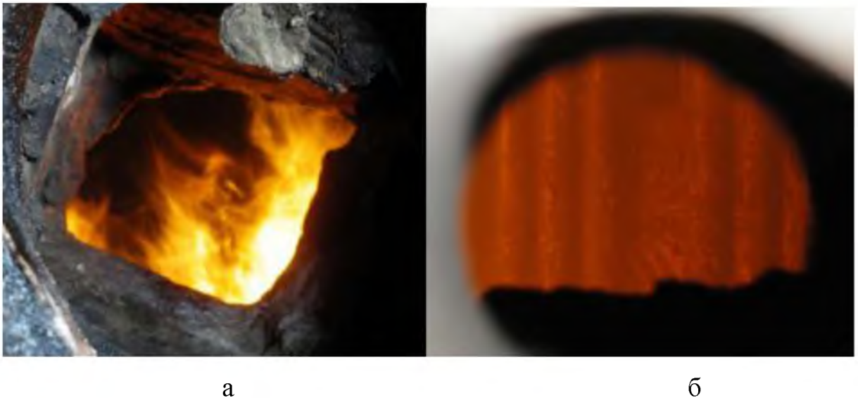
Рис. 5.5. Общий вид факельного сжигания нефти в топке котла ДКВР-10/12 а) горящий факел сырой нефти (вид через смотровой люк в топке котла) – исходный вариант; б) горящий факел той же самой нефти, но подготовленной к сжиганию в виде водотопливной эмульсии.
