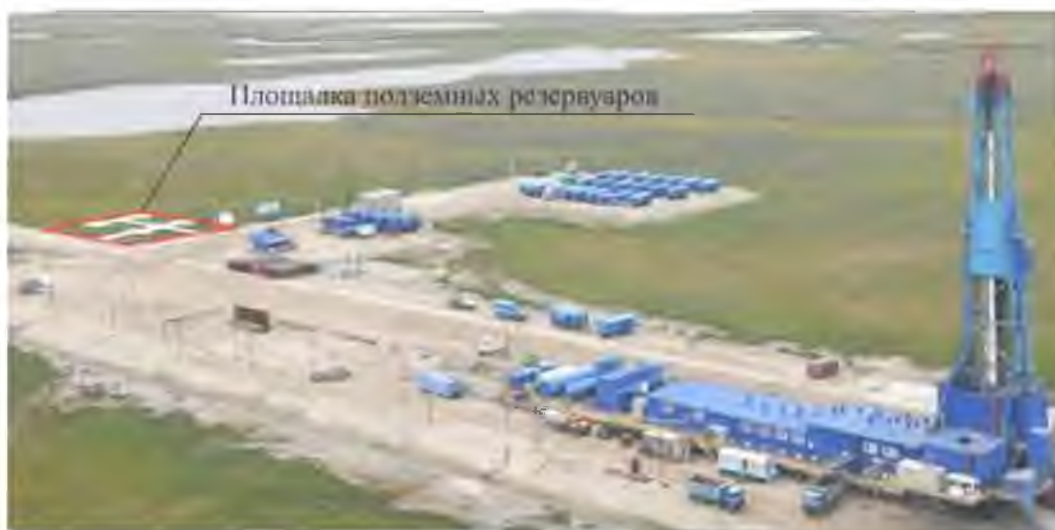
Рисунок 1.14 – Площадка подземных резервуаров, примыкающая к кусту газовых скважин
