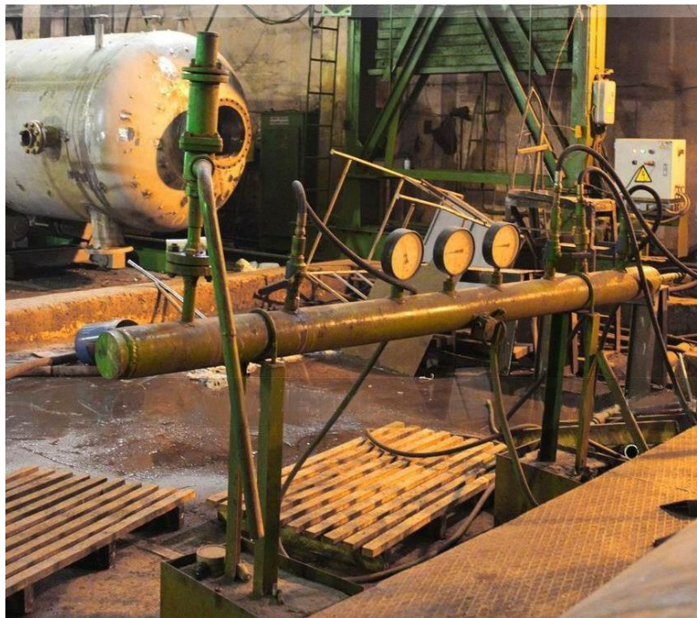
Рис.1. Стенд для гидроиспытаний сосудов и аппаратов, работающих под давлением
