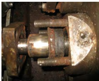
Рисунок 1. Узел трения «плунжер-уплотнение» электронасосного дозировочного агрегата. Фланец на грумбуксе снят
